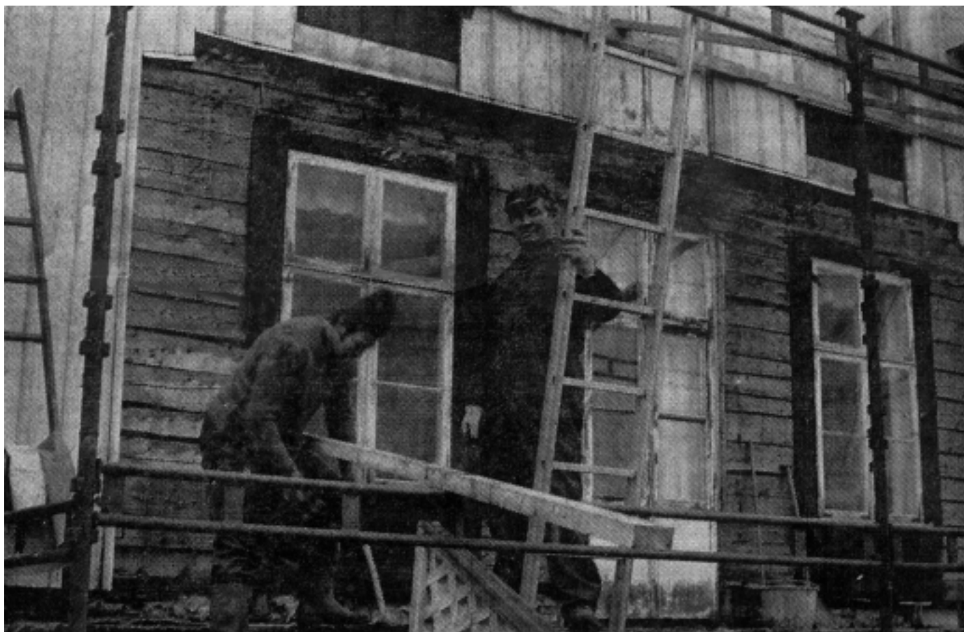
Roland és Axel Petterson, a Borås Byggproduktions AB építői elsőként érkeztek a helyszínre, amikor - a karácsonyi ünnepek után - megkezdődött Tångagärde százéves gerendaépületének felújítása. A képen a tó felőli homlokzat állványozása látható. (Ulricehamns Tidning, 1975. jan. 4.)
